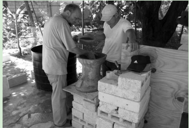
Ein EcoSur-Fachmann erläutert dem nicaraguanischen Ingenieur die Konstruktion der Trockentrenntoilette in Port-au-Prince, Haiti
